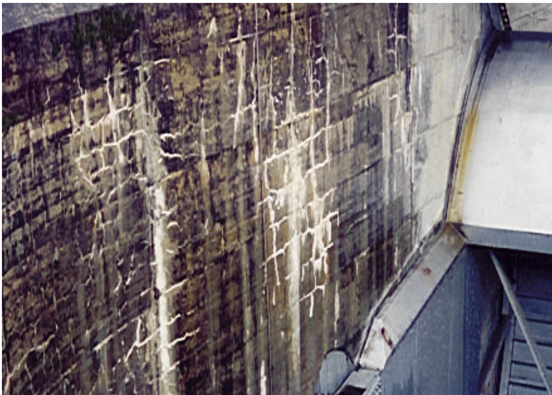
Figura 28- Fissura em pilar de Vertedouro com expansão e travamento de comporta – Obra nos Estados Unidos.
