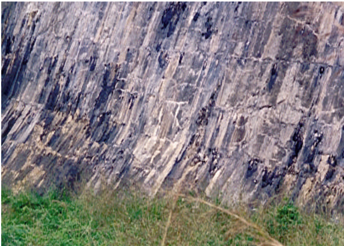
Figura 23 – Fissuras poligonais, em paramento de barragem – Obra no Brasil.
