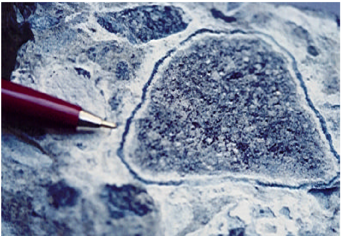
Figura 07 – Bordas de RAA no agregado- Obra nos Estados Unidos
