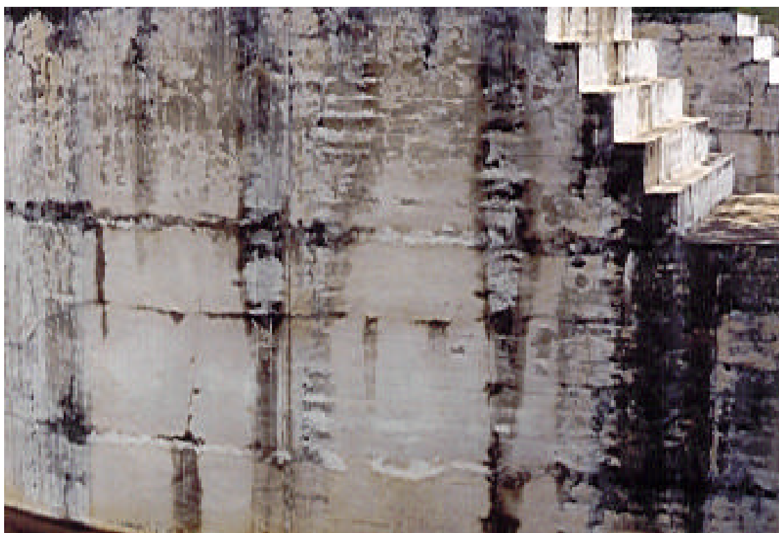
Figura 27 – Fissuras superficiais, na junta de construção – Obra no Brasil.
