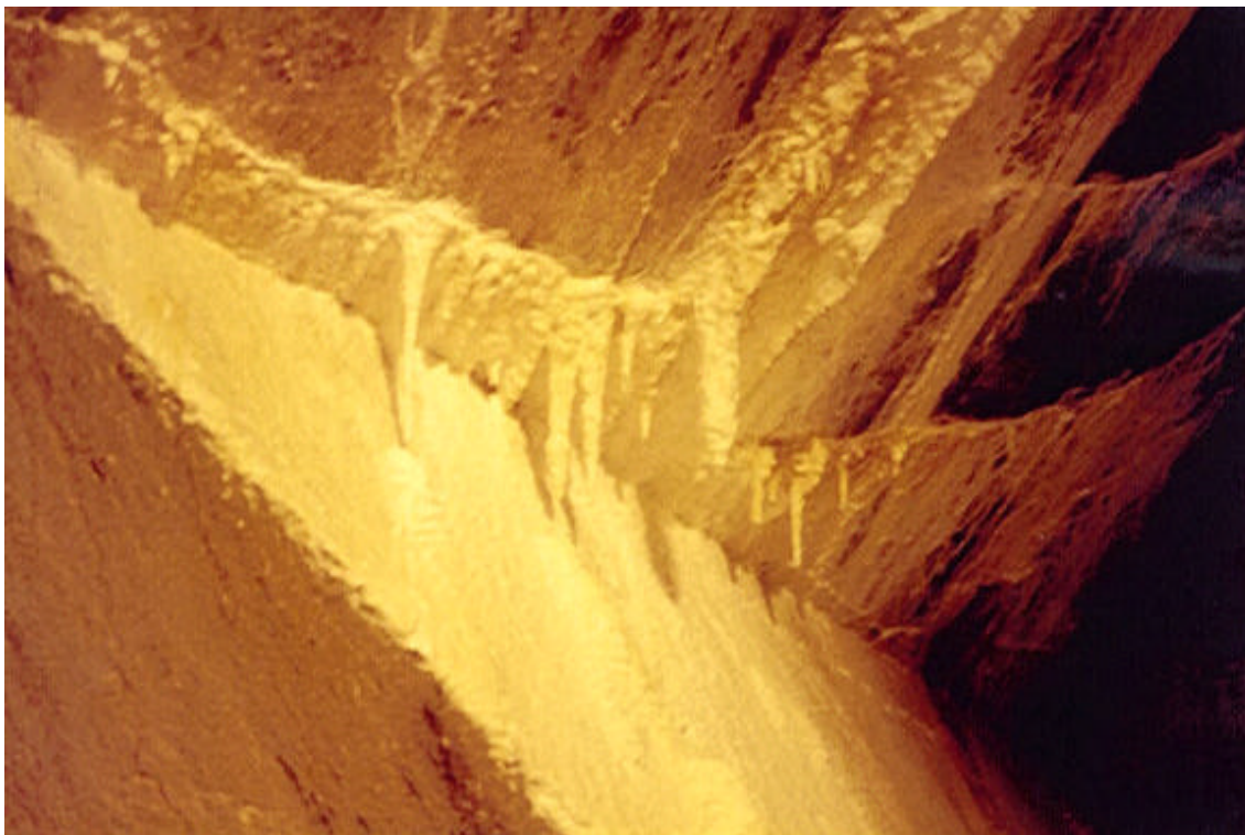
Figura 18- Exsudação de gel da RAA em fissuras de expansão- Obra nos Estados Unidos.
