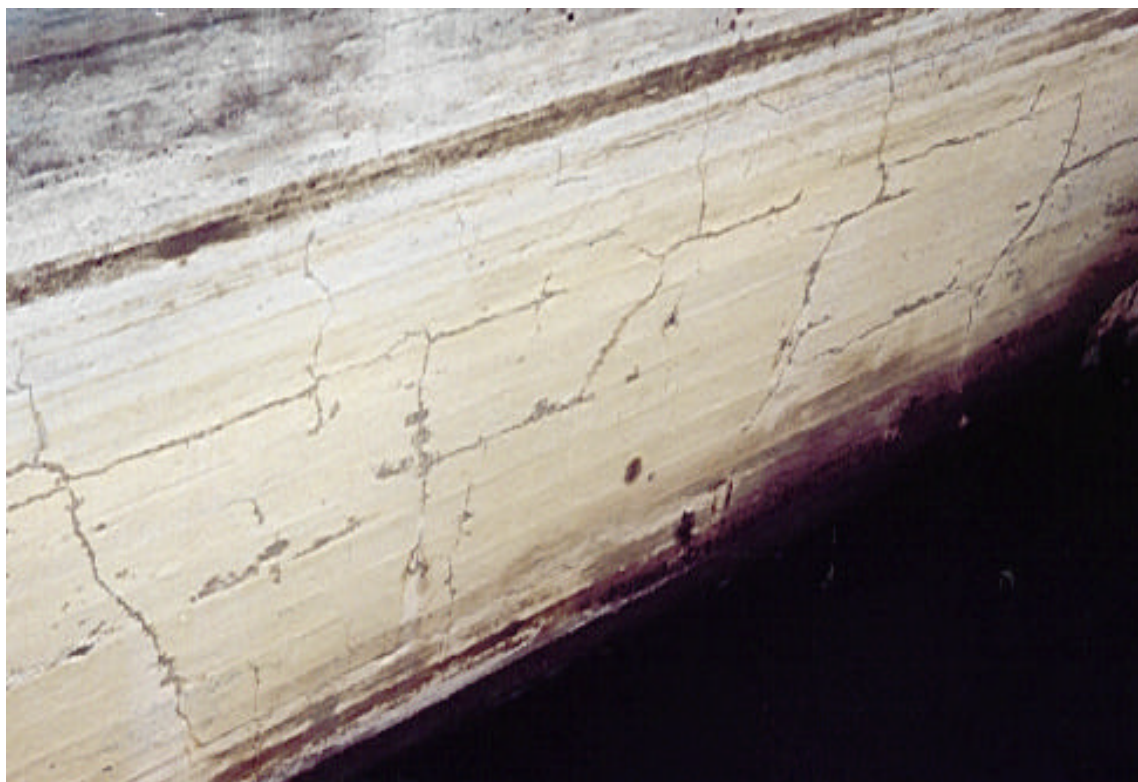
Figura 24- Fissuras na direção da maior dimensão – Obra no Brasil
