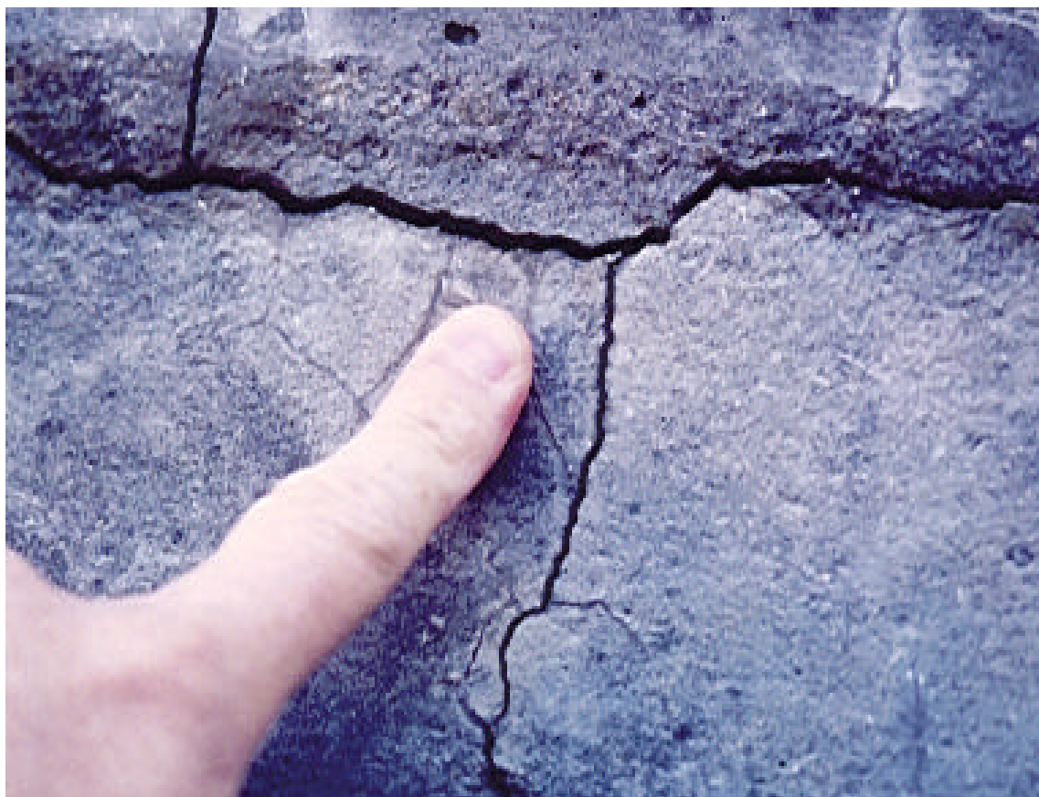
Figura 26- Fissuras de grande abertura devido à RAA – Obra nos Estados Unidos.
