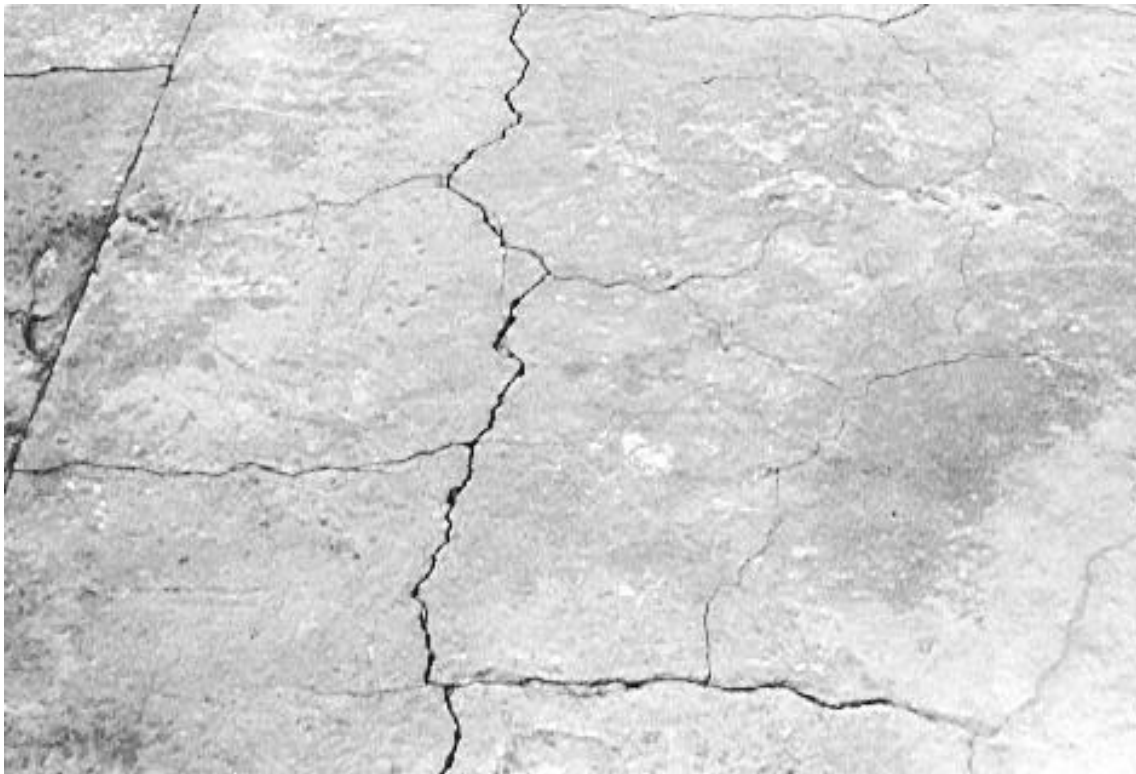
Figura 22- Fissuras poligonais na superfície, devido à RAA- Obra no Brasil.
