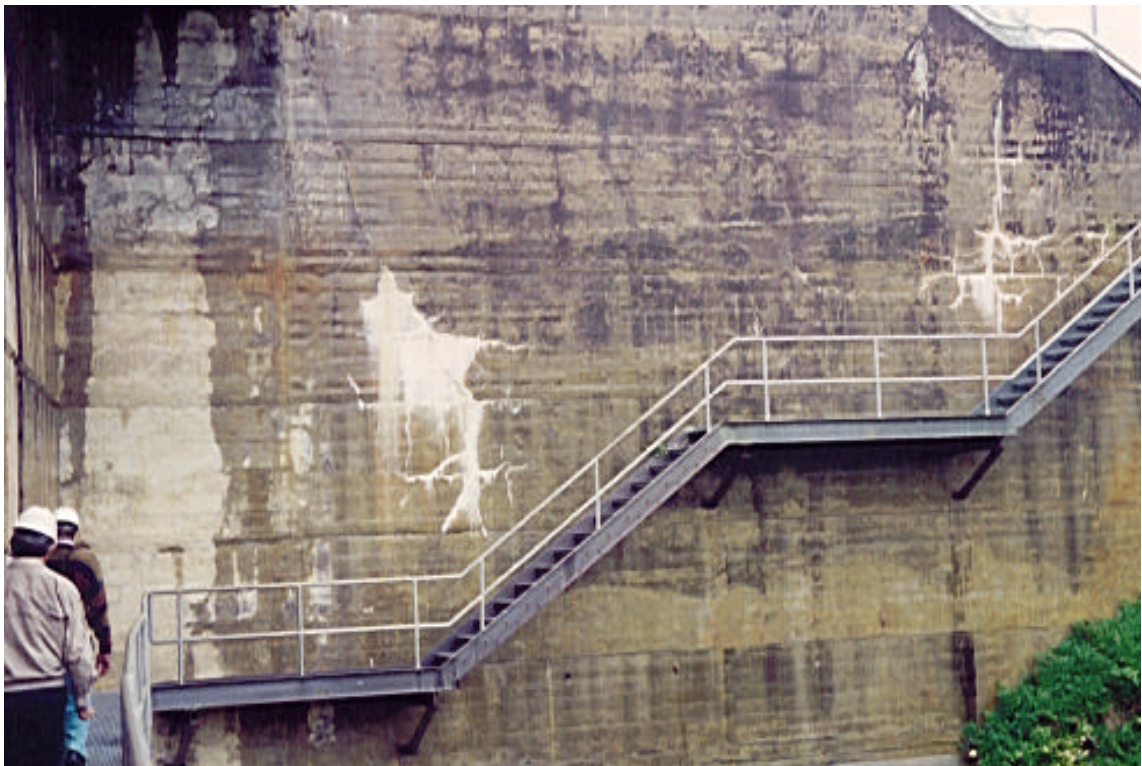
Figura 17 – Exsudação de gel da RAA em fissuras de expansão- Obra nos Estados Unidos.
