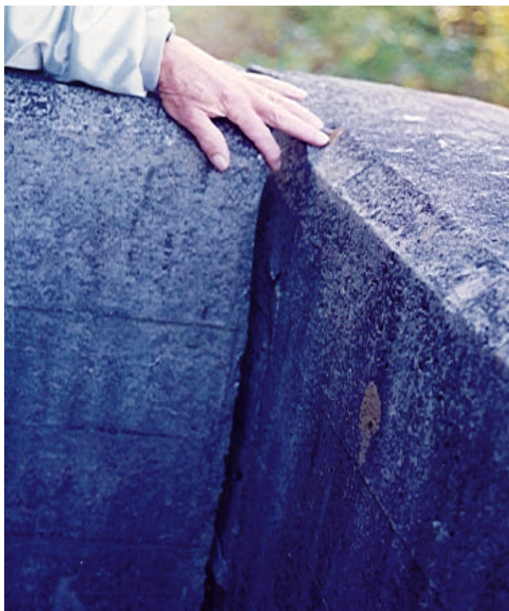
Figura 21 – Abertura de junta de contração devido à RAA- Obra nos Estados Unidos.
