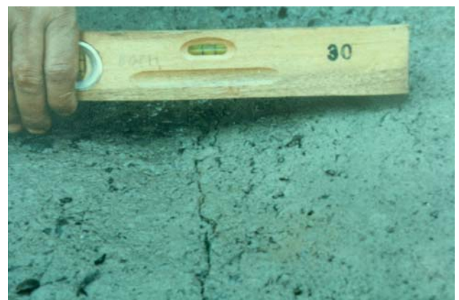
Figura 11- Fissura decorrente do desnivelamento das “cabeças” de concretagem.
