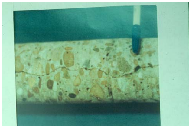
Figura 27- Testemunho (da região mostrada na Figura 26) evidenciando a extensão da fissura.
