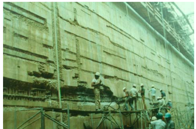
Figura 05- Aspectos dos trabalhos de recuperação necessária, decorrente dos danos citados nas Figuras 03 e 04.
