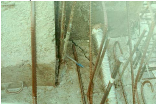
Figura 23- Fissura em viga protendida, devido à concentração de tensões e à deficiência de fretagens.
