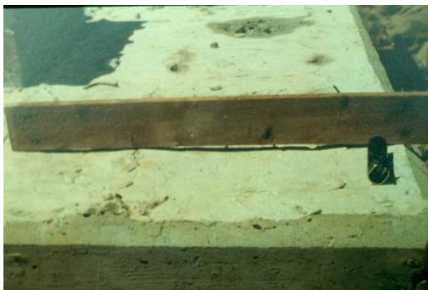
Figura 07- Assentamento plástico causando a fissuração ao redor das barras de armação.
