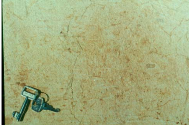
Figura 12- Fissuras causadas pela retração por secagem.
