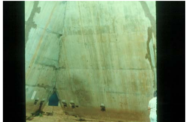
Figura 24- Fissuras ocorridas em blocos de barragem, devido à geometria da estrutura e à velocidade de concretagem.
