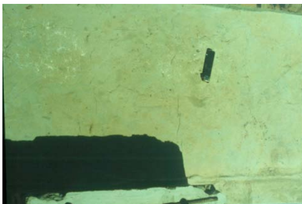
Figura 08- Fissuração decorrente do assentamento plástico
