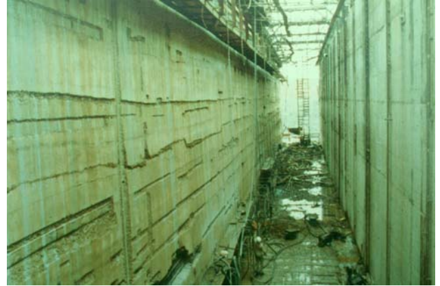
Figura 04- Aspecto dos danos causados pelo procedimento citado na Figura 03.
