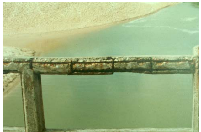
Figura 15- Situação decorrente de fissuração por corrosão, devido ao recobrimento insuficiente.
