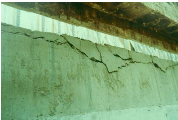
Figura 03- Fissuras causadas pela subida rápida da forma deslizante, com o concreto ainda plástico.
