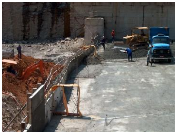
Fig. 6 Picada RCC dam, lateral view of the formwork panels and double curvature Barrage BCR de Picada, vue latérale des panneaux de coffrage et de la double courbure
