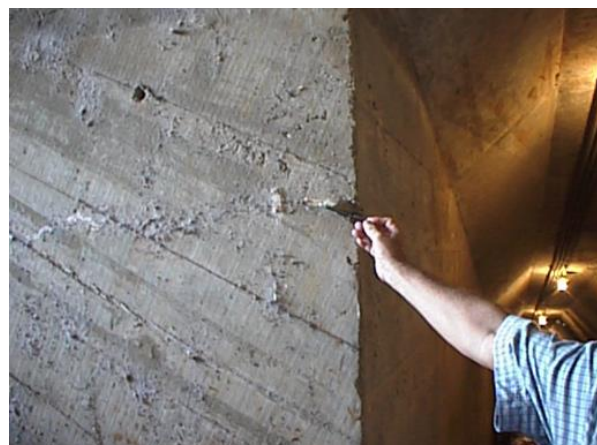
Figura 04-13- Fissura sub-horizontal na face lateral da galeria de entrada, desde jusante, em uma Barragem construída ao redor de meados de 1970, inspecionada 35 anos após.
