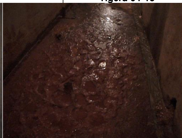
Figura 04-17- Aspecto de material vermelho amarronzado depositado no piso da galeria referida na Figura 04-13
