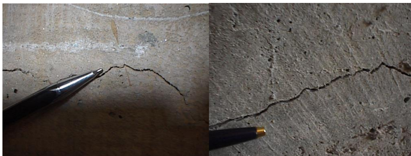
Figuras - 04-14- Detalhes da Fissura citada na Figura 04-13
