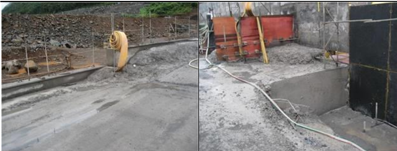
Figuras 08-03-Adoção de junta de contração, próxima a uma junta de construção do CVC de Face, que poderia ser solucionada com um Planejamento. Obra construída no Brasil em 2009
