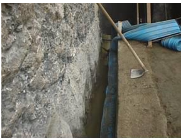
Figura 08-01- “ Esquecimento ” de colocação de veda junta” em uma junta de contração de Barragem construída em CCR, no Brasil- 2000
