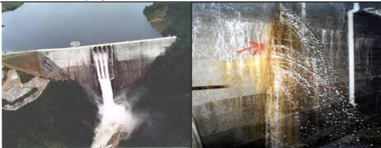
Figuras 06-04- Aspectos de precária estanqueidade da Face (em GE-RCC) de uma Barragem em CCR, de Projeto Hidrelétrico na América do Sul, terminada em 1996
