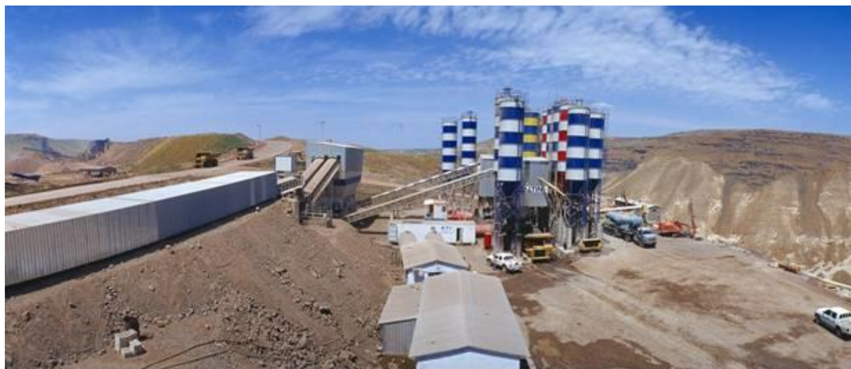
Figura 10-10-Vista do sistema de refrigeração –aspersão de água gelada na correia transportadora dos agregados- na obra de Al Wehdah em CCR- Jordânia/Síria- 2006.
