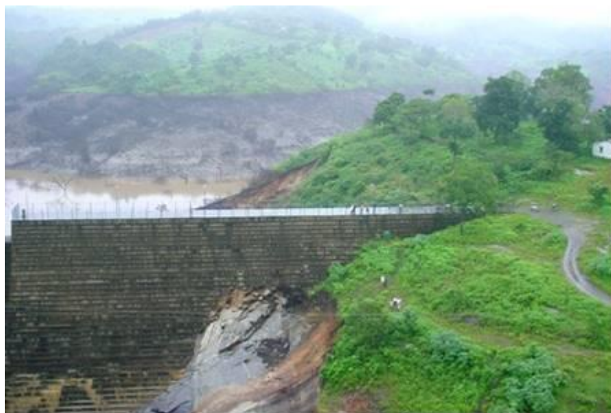
Figura 11-01- Ruptura da fundação rochosa sob a barragem de Camará- Brasil- 2004
