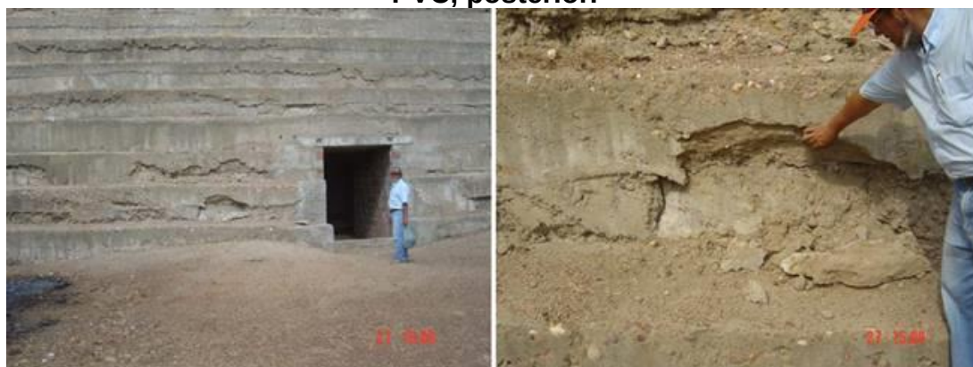
Figuras 06-03- Aspectos de precário CCR executado em Obra de Barragem no Brasil, construída em 1995
