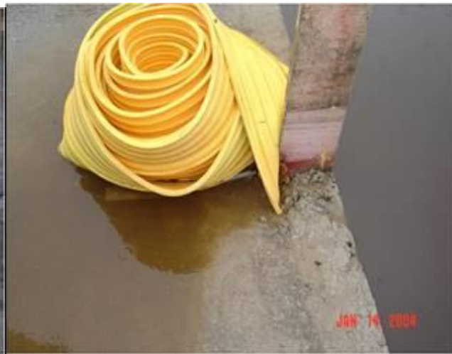
Figura 08-05- Falta de planejamento e cuidado na metodologia de instalação do veda junta na face de montante, além de inadequada vibração do CVC da face. em Barragem construída em CCR, no Brasil- 2004
