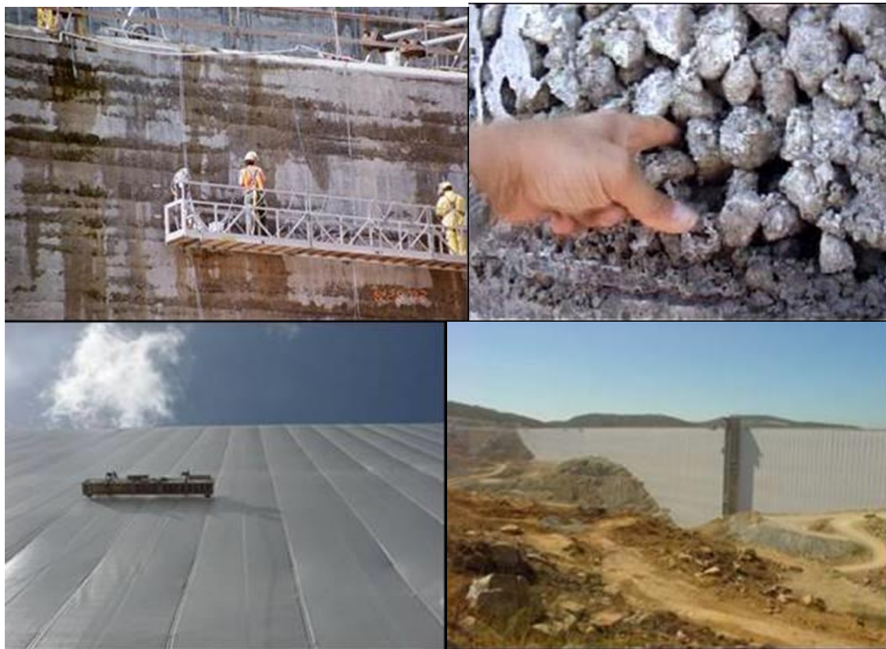
Figuras 06-02- Aspectos das do GE-RCC ALVEOLADO (com “Bicheiras”) na face da Barragem de Olivenhain-USA, terminada em 2003, tendo que adotar uma Manta de PVC, posterior.
