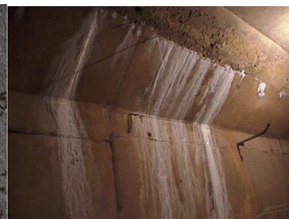
Figura 04-15- Aspecto de percolação e deposição de material esbranquiçado na galeria referida na Figura 04-13
