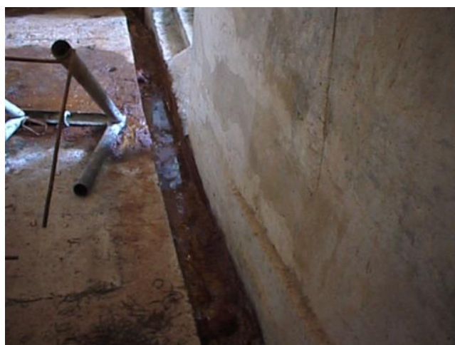
Figura 04-16- Aspecto de material vermelho amarronzado depositado na canaleta de drenagem da galeria referida na Figura 04-13
