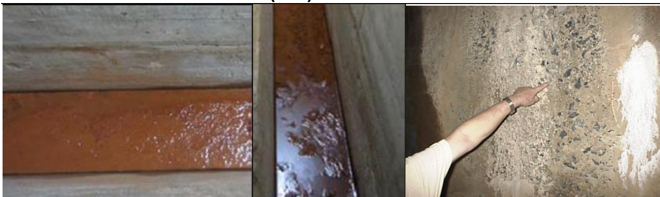
Figuras 04-19- Aspectos material depositado e de erosão química do concreto junto a deposição do material esbranquiçado, depositado, semelhante ao ocorrido na obra exemplificada anteriormente
