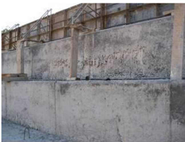
Figura 08-04- Falta de planejamento na metodologia de uso de formas para o talude de jusante de Barragem construída em CCR, no Brasil- 2008
