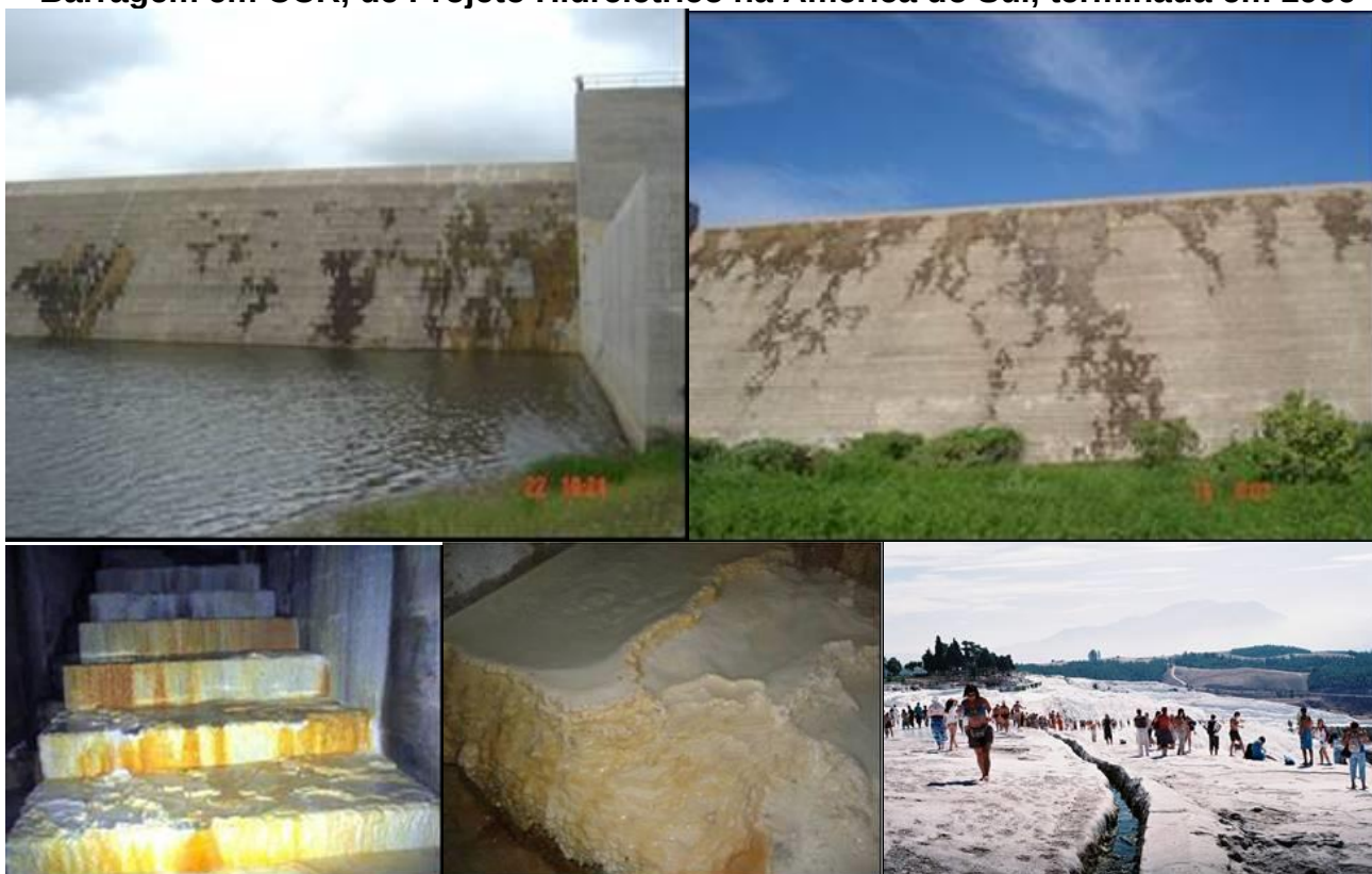
Figuras 06-05- Aspectos de precária estanqueidade da Face de uma Barragem em CCR, Brasileiras com Face em Concreto Vibrado (??!!) Convencionalmente (CVC) nos anos 1999-2000
